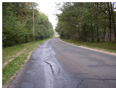
Figure 1. Exemple de route fissurée par le retrait-gonflement des argiles, en lien avec les sécheresses estivales
